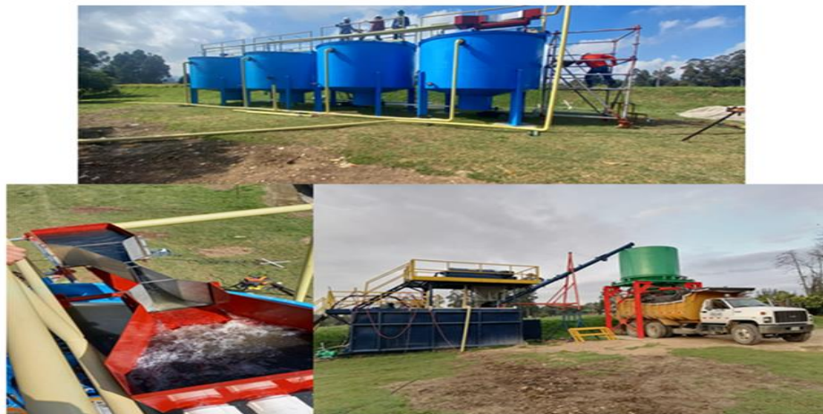
Proceso de tratamiento y extracción de lodos.
