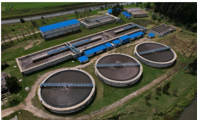
Planta de tratamiento de aguas residuales PTAR CHÍA II Fuente: Dirección técnico operativa
